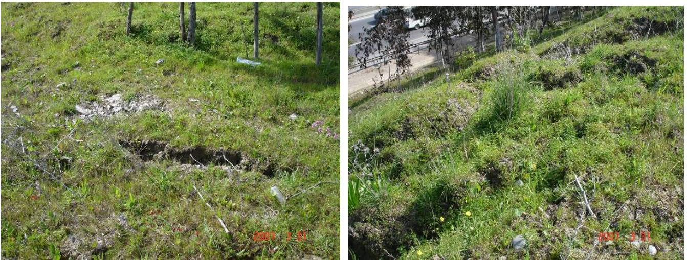
Figures 11 et 12. Nouveaux glissements de part et d'autre de la coulée de boue
