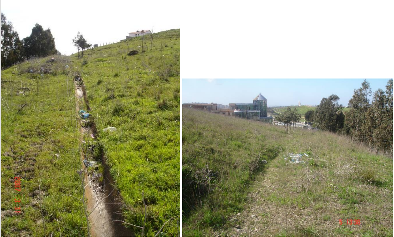
Figures 9 et 10. Caniveau en crête de talus, inexistant par endroit
